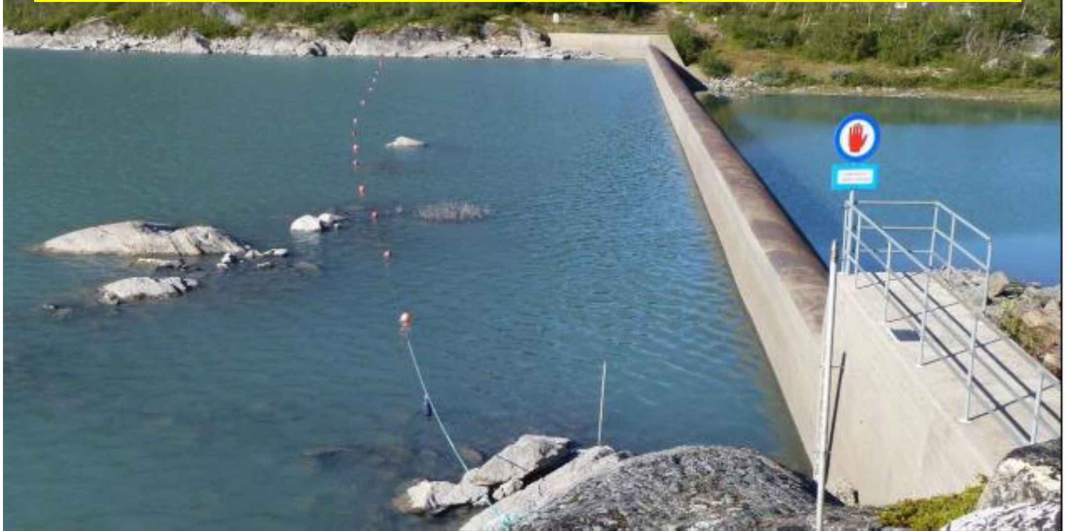
Figur 4-3: Det er åpenbart ikke ønskelig med ferdsel over denne smale overløpsterskelen. Atkomsten er derfor sperret av i tillegg til varsling med skilt. (Foto: Kjell Molkersrød, NVE)
